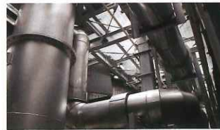
プラント配管
